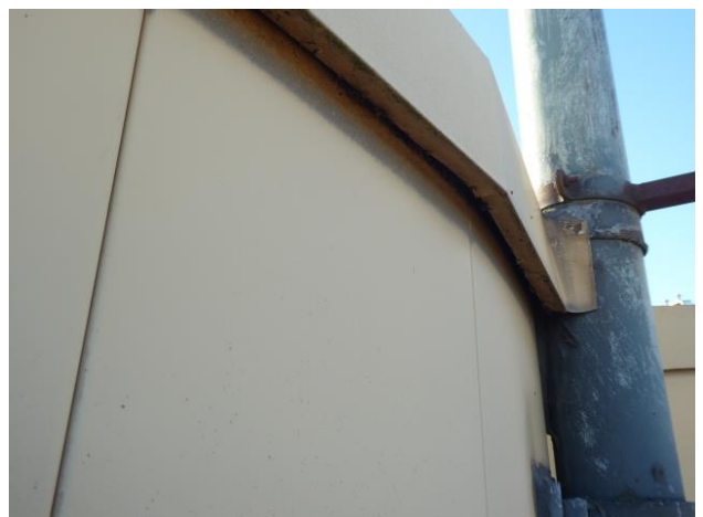
Abb. 8: Glattwandige Verkleidungen ohne geeigneten Quartiere für Fledermäuse im oberen Bereich des Wasserspeichers.
